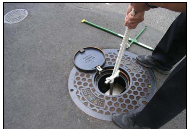
第二中学校敷地内のマンホールトイレ
