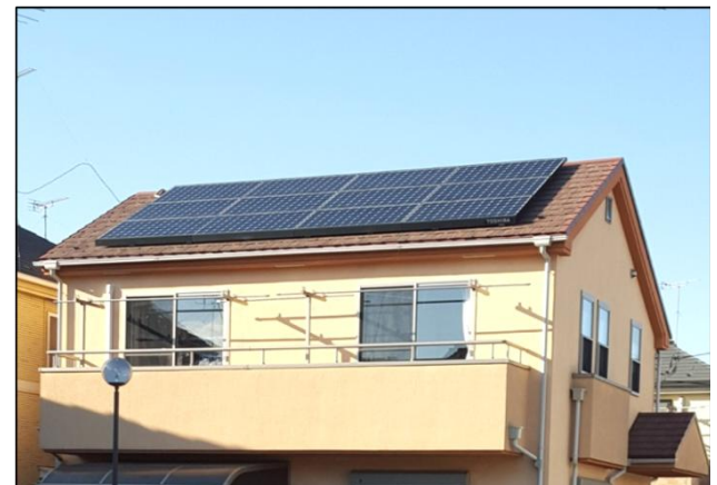
モニター助成により設置された太陽光発電設備
