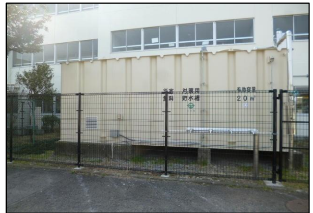
市内の小学校に設置された災害対策用飲料水槽
