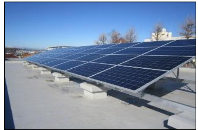
小川西保育園に設置された太陽光発電設備
