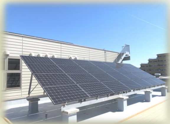
屋上の太陽光発電
