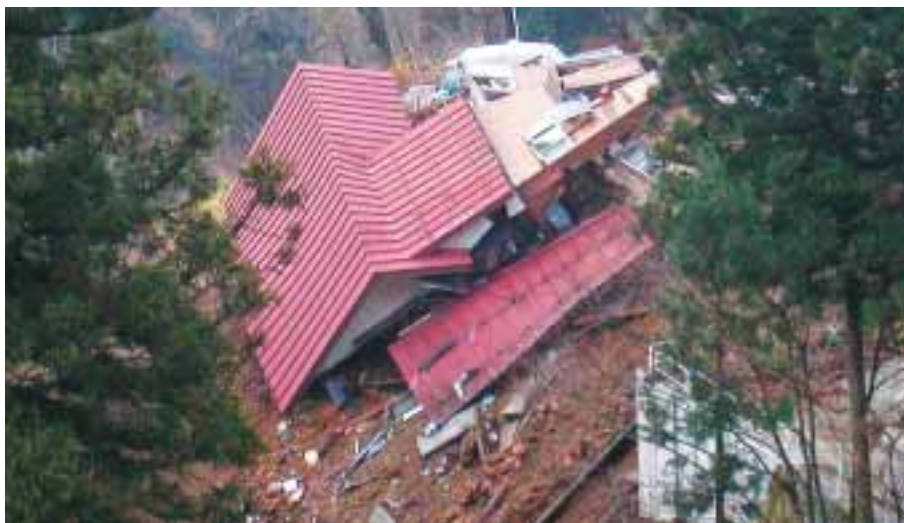
土砂崩れで全壊した住宅（栃尾市）
